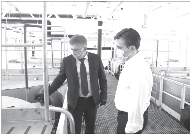
Значимое событие для наших жителей - это чистая вода. Гендиректор АО «Водоканал» Александр Морозов и губернатор области Станислав Воскресенский на станции обезжелезивания.
